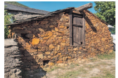
Las construcciones tradicionales de Nogueira aprovecharon las piedras de los aluviones mineros
